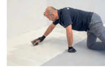
IT 2_ Distribuire la colla sul pavimento utilizzando l'apposita spatola a denti inclinati (10x10 mm), stendere il collante superando di 5/10 cm la superficie della lastra.
