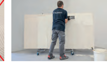
IT 4_ Stendere il collante sul retro della lastra utilizzando l'apposita spatola a denti quadrati (3x3 mm) e accertarsi che le righe dell'ultima stesura siano nella stessa direzione di quelle della spalmatura della lastra. Durante la fase di stesura, la lastra dovrà essere in posizione verticale e fissata al telaio di movimentazione con ventose di sicurezza posate sopra al carrello per il trasporto con ruote.
